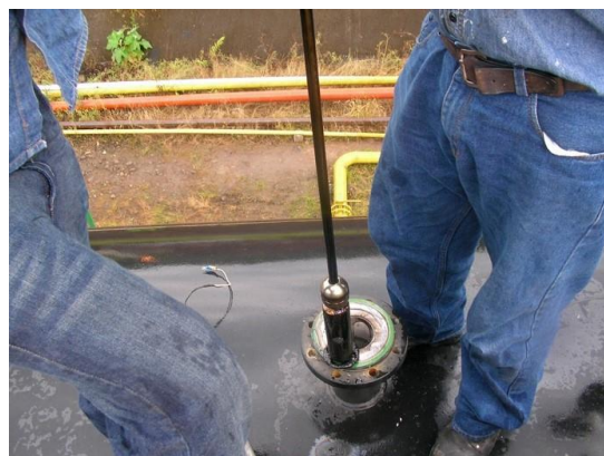
Figura2. Medidor de interfase del tipo boya
